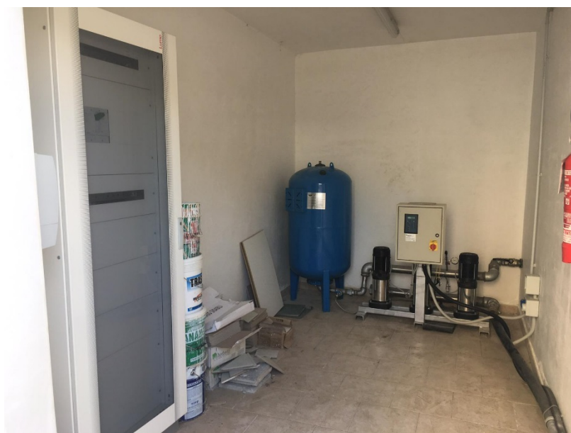
Figura 7 – Autoclave e quadro ENEL presenti nel locale pompe
