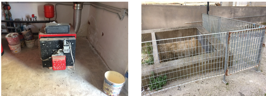
Figura 1 – Centrale termica in disuso
