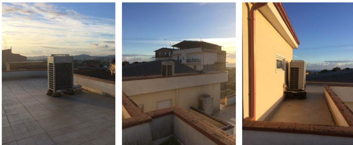
Figura 9 – Macchine multisplit in copertura
