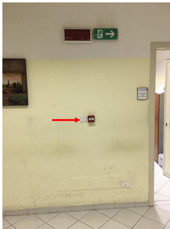
Foto 5 - Pulsante allarme incendi con pannello ottico sonoro (esempio corridoio con relativo segnale di indicazione dell'uscita di sicurezza)
