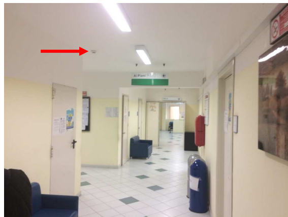
Foto 3 - Rilevatori di fumo corridoi interni (freccia in rosso)
