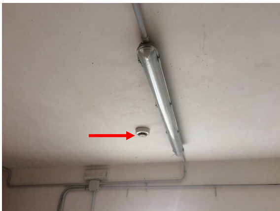
Foto 2 - Rilevatore di fumo locale tecnico piano terra (freccia in rosso)
