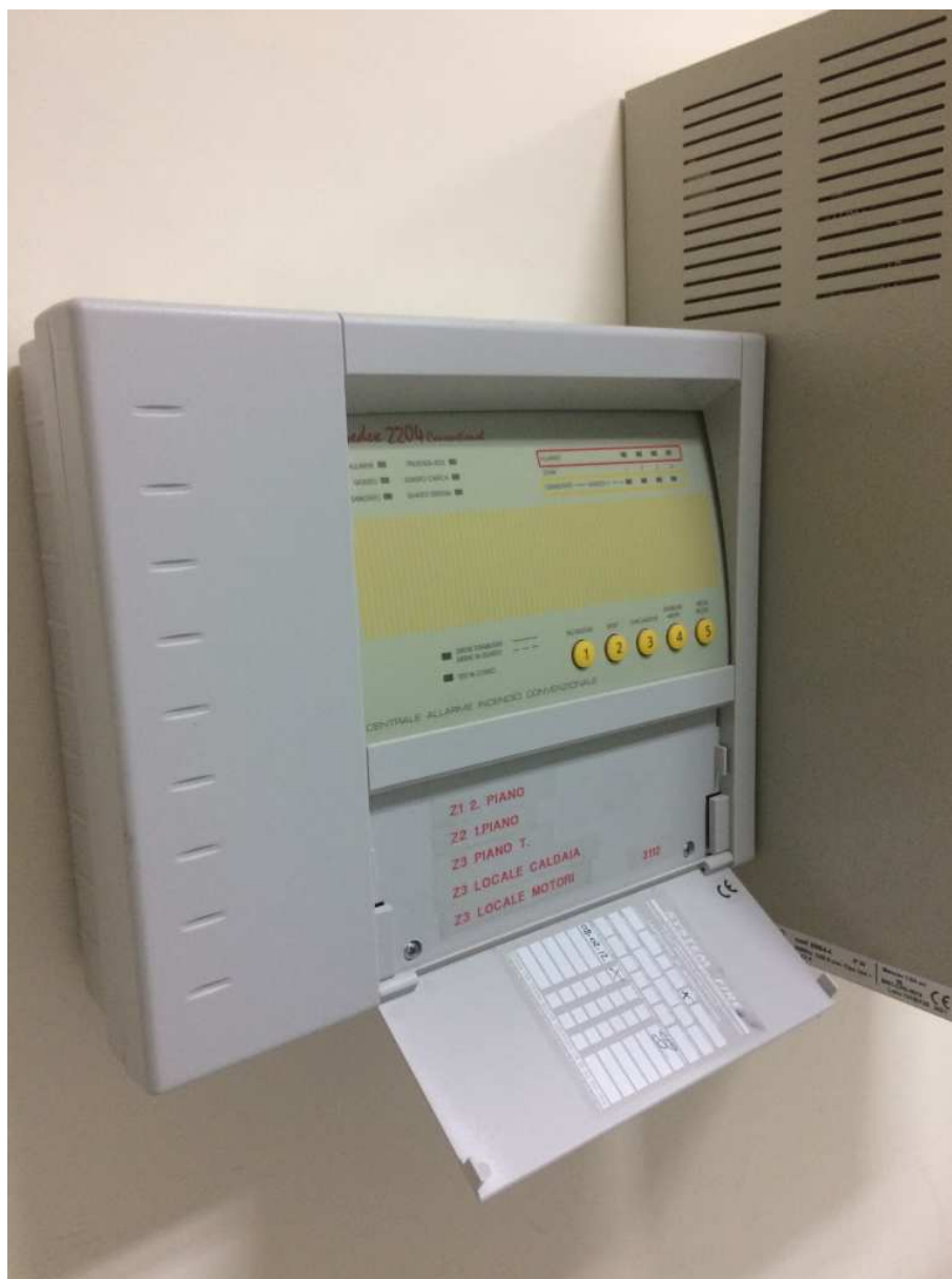
Foto 1 - Centrale di allarme incendi esistente
