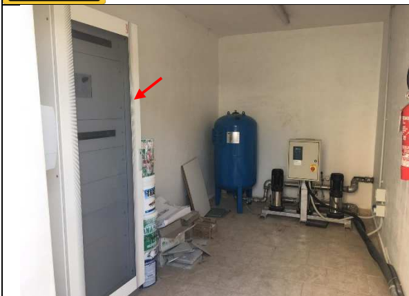
Foto 6 - Panoramica della centrale idrica; sul lato sinistro la freccia indica il Quadro Generale ENEL
