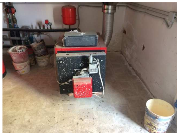
Foto 7 - Locale centrale termica (attualmente fuori esercizio)
